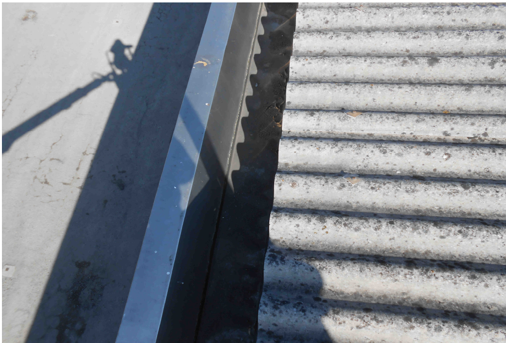
EDIFICIO N° 6 grondaia
